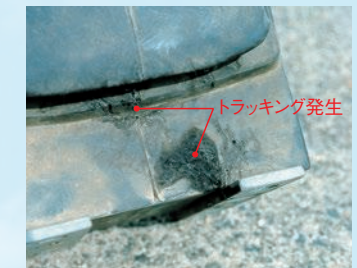
汚損、多湿状態での使用例(使用後約10年)
