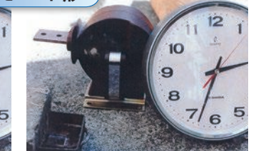
図-4 自然消火後
